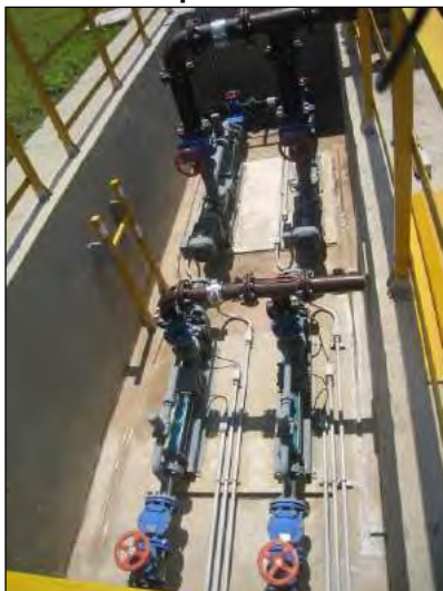
Figura 237: Recalque do lodo e da espuma.
