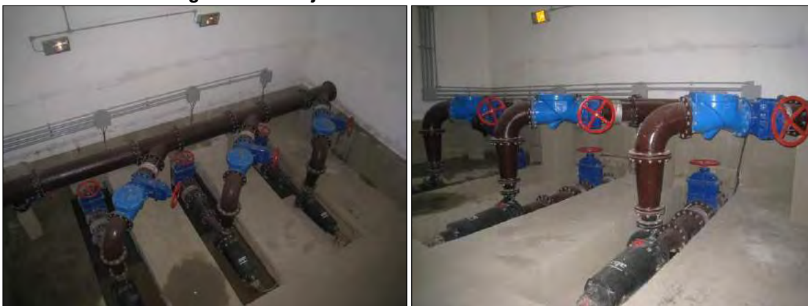
Figura 223: Conjuntos moto bomba da EEE Passaúna.
