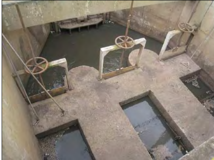
Figura 250: Chegada de esgoto.
