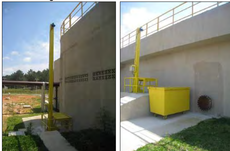
Figura 235: Elevadores da ETE Passaúna.
