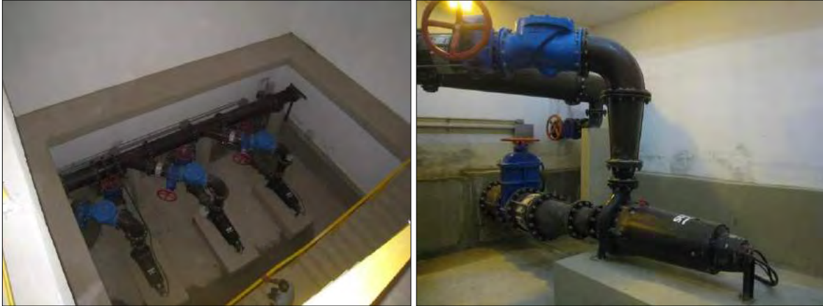
Figura 219: Conjuntos moto bomba da EEE Gerdau.
