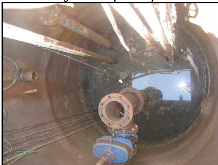
Figura 246: Poço de sucção.
