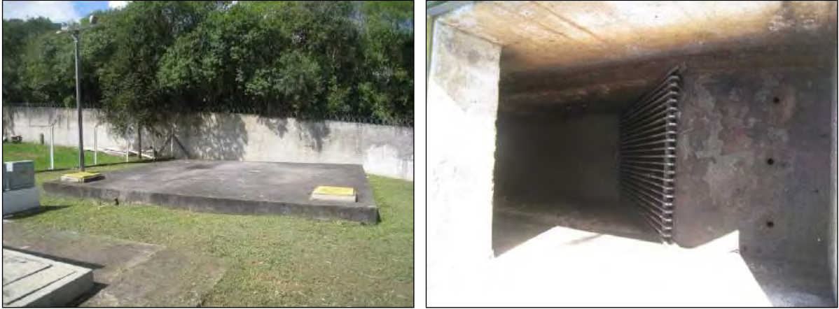
Figura 241: Tanque de chegada e gradeamento.
