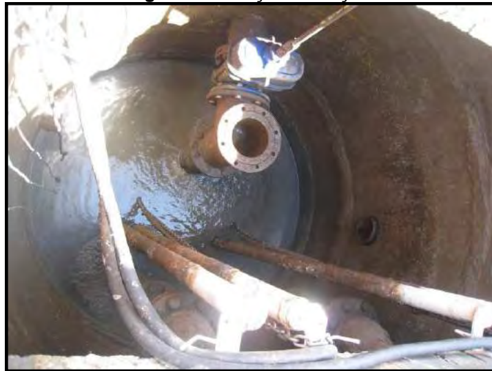
Figura 242: Poço de sucção.
