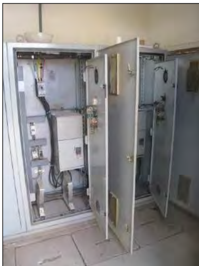
Figura 247: Acionamento da EEE Vila Angélica.
