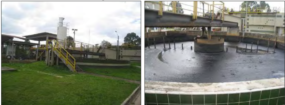
Figura 261: Adensador do lodo.
