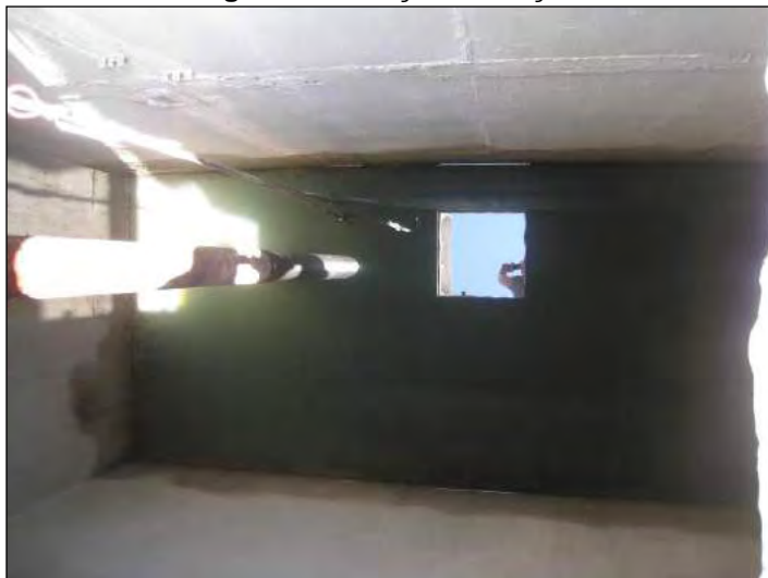
Figura 236: Poço de sucção.
