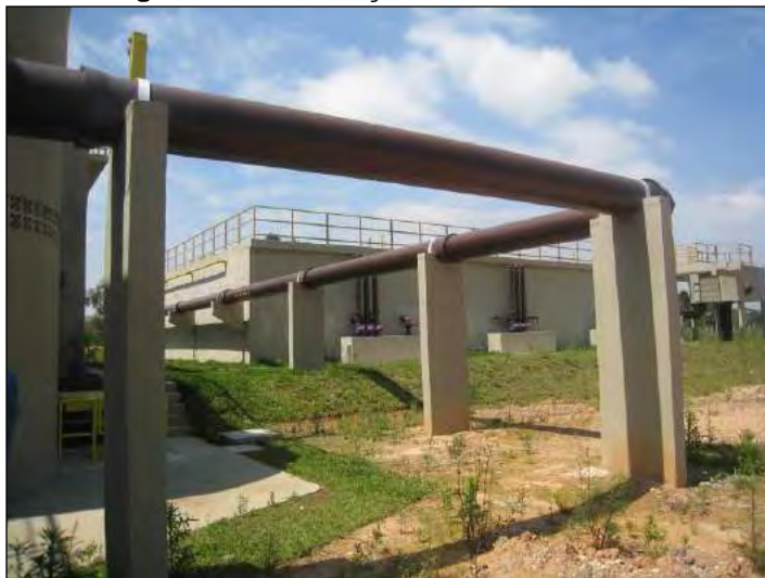
Figura 234: Tubulação da ETE Passaúna.
