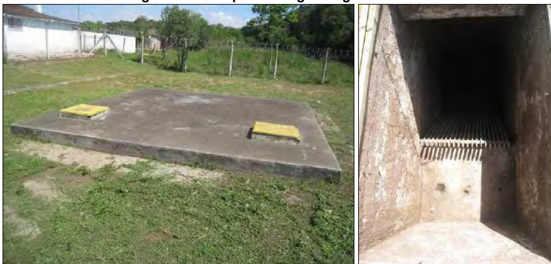
Figura 245: Tanque de chegada e gradeamento.
