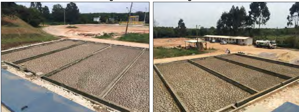
Figura 206: Leitos de secagem.
