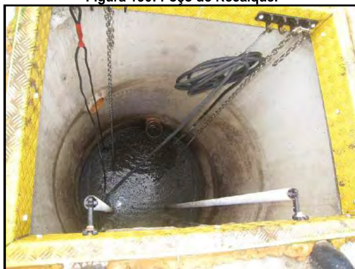
Figura 190: Poço de Recalque.
