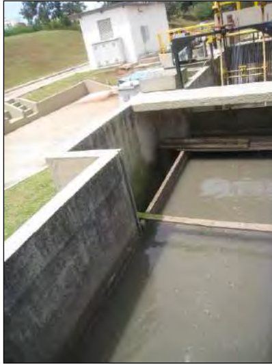
Figura 199: Chegada de esgoto.
