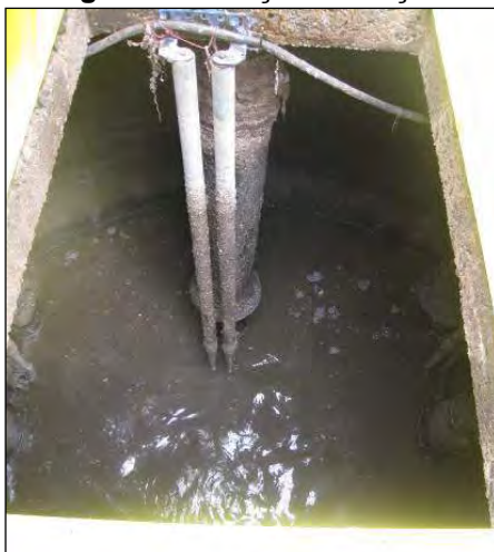
Figura 195: Poço de sucção.
