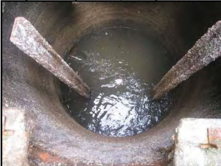
Figura 210: Poço de recalque com gradeamento.
