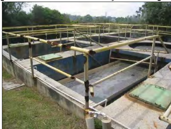
Figura 212: Estado de conservação da ETE Iguaçu.
