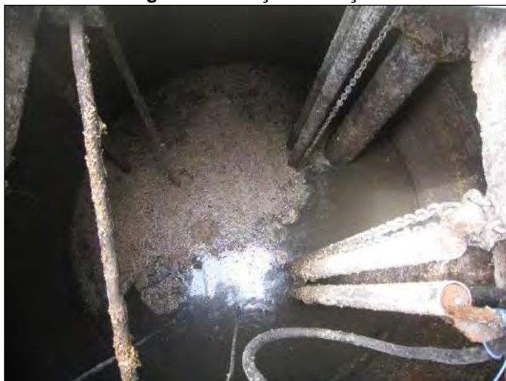
Figura 211: Poço de sucção.
