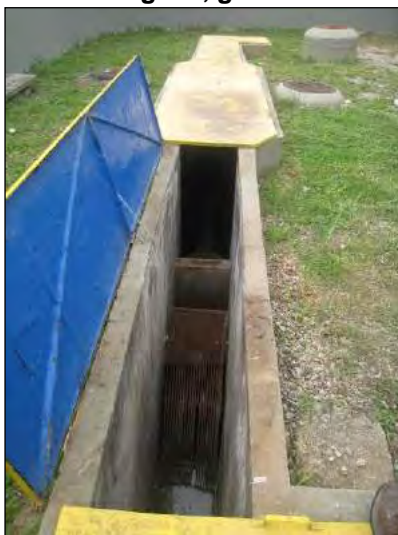
Figura 189: Canal de chegada, gradeamento e desarenador.
