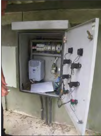
Figura 186: Acionamento da EEE Costeira I.
