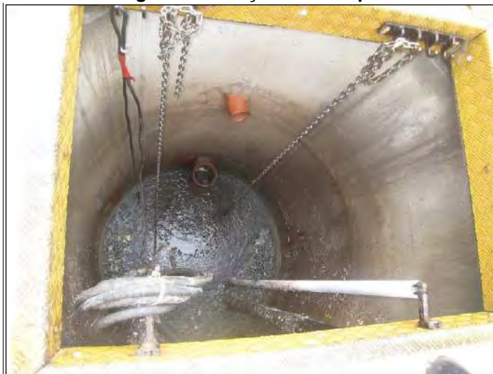
Figura 185: Poço de Recalque.
