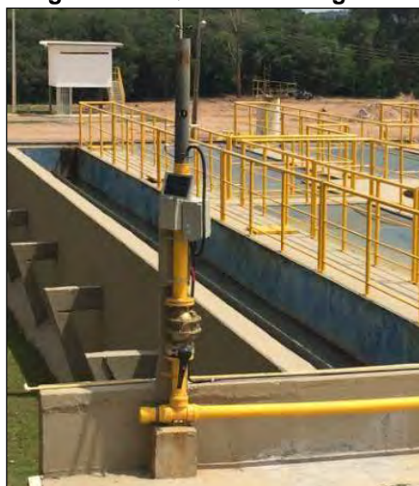
Figura 205: Queimador de gases.
