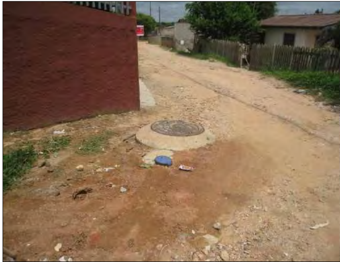
Figura 154: Macromedidor de Água Tratada.
