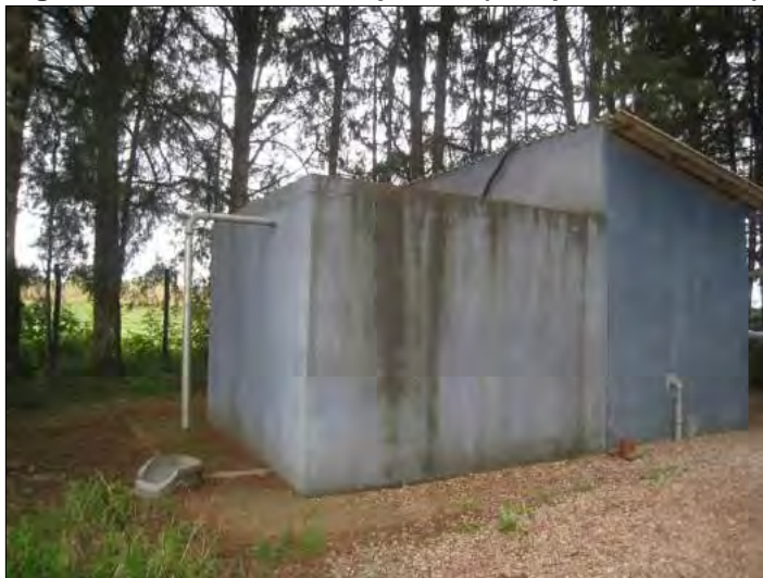
Figura 173: Reservatório Apoiado (Tanque de Contato).
