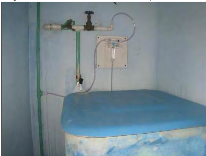
Figura 159: Sistema Dosador de Cloro por Gravidade.
