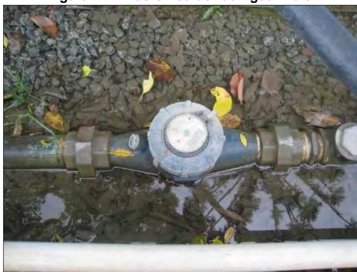
Figura 144: Macromedidor de Água Bruta.
