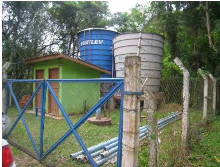
Figura 178: Captação de Água Bruta.
