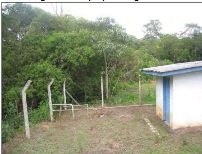
Figura 175: Captação de Água Bruta.
