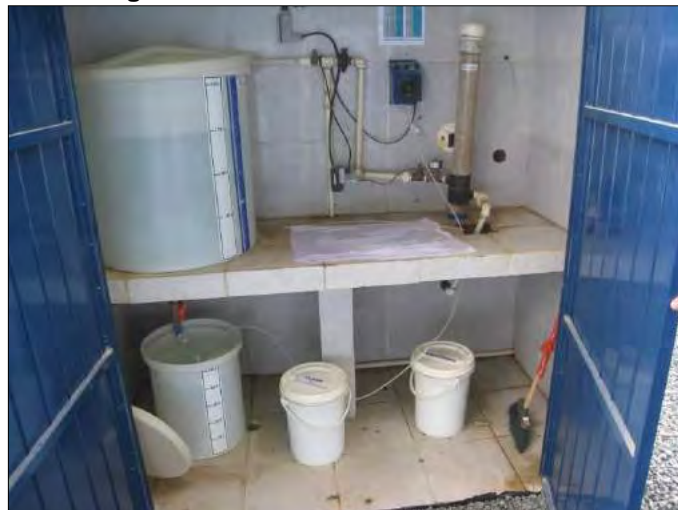
Figura 143: Bomba Dosadora de Cloro.
