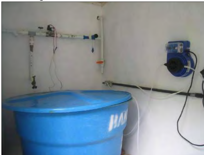
Figura 160: Bomba Dosadora de Cloro.
