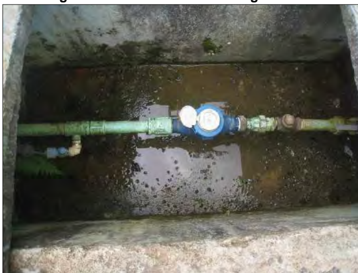
Figura 148: Macromedidor de Água Bruta.
