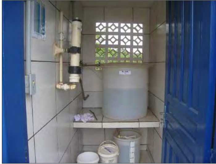
Figura 151: Bomba Dosadora de Cloro.
