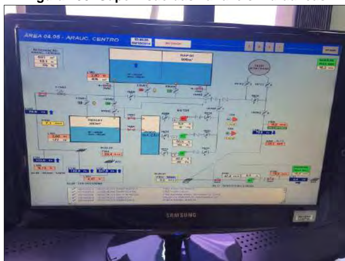
Figura 138: Supervisão das variáveis hidráulicas.
