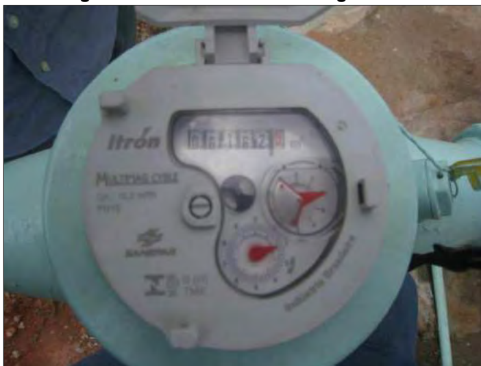
Figura 153: Macromedidor de Água Bruta.
