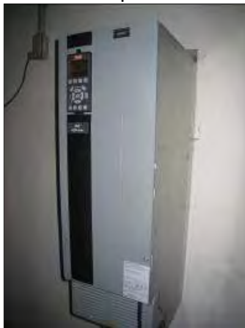
Figura 109: Acionamento por inversos de frequência.
