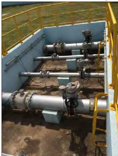
Figura 129: Adutoras de saída de água tratada.
