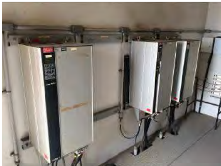
Figura 116: Acionamento por inversor de frequência.
