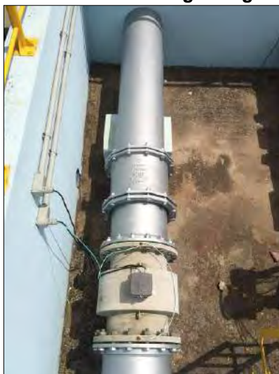
Figura 124: Adutora de chegada água tratada.
