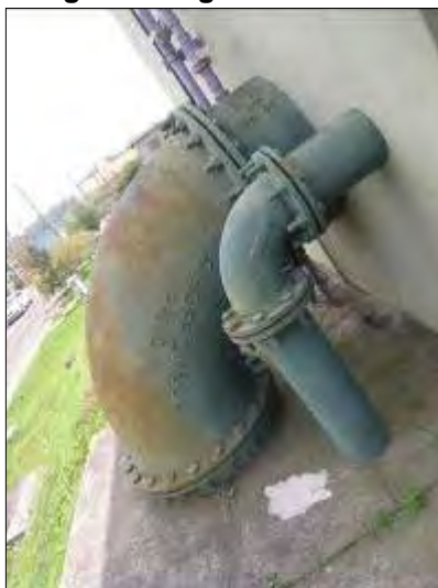
Figura 95: Chegada de água bruta na ETA Industrial.
