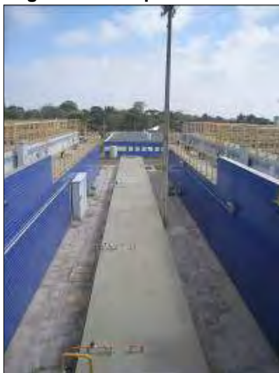
Figura 81: Tanque de contato.
