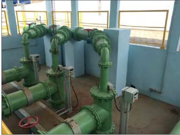
Figura 127: Elevatória de Água Tratada Costeira.
