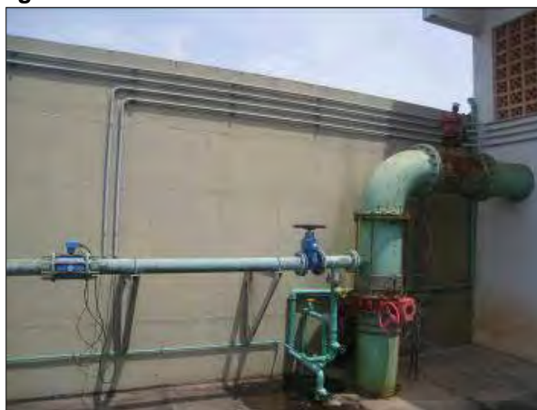
Figura 112: Adutoras de saída da ETA Industrial.
