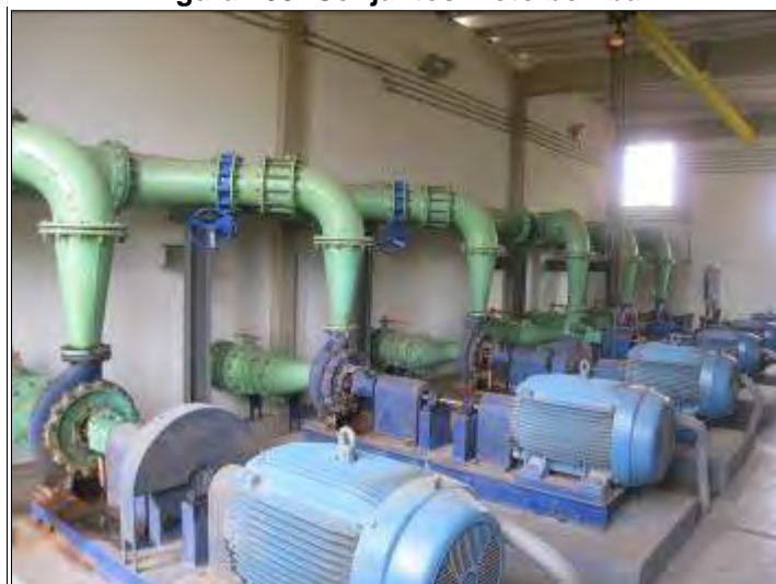
Figura 108: Conjuntos moto bomba.
