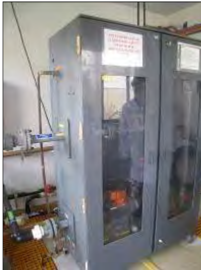
Figura 103: Equipamento de formação do dióxido de cloro.
