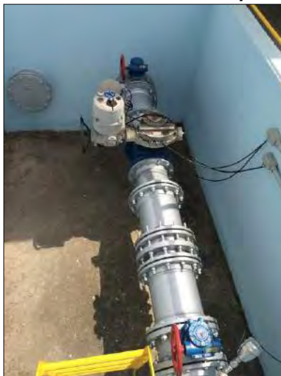
Figura 130: Válvula elétrica da unidade operacional Costeira.
