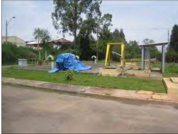
Figura 104: Misturador de água de limpeza dos filtros.
