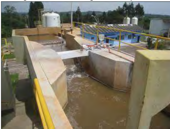
Figura 96: Caixa de chegada e calha parshall.
