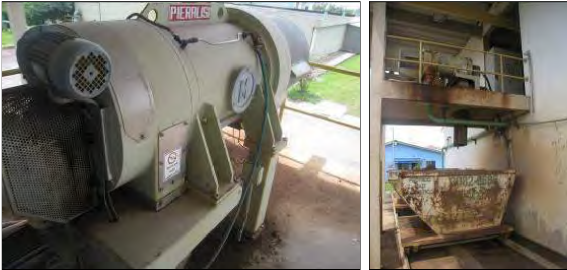
Figura 106: Sistema de separação do lodo.
