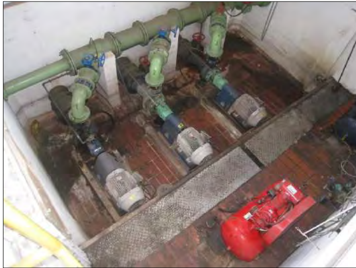
Figura 118: Elevatória de água tratada Centro.
