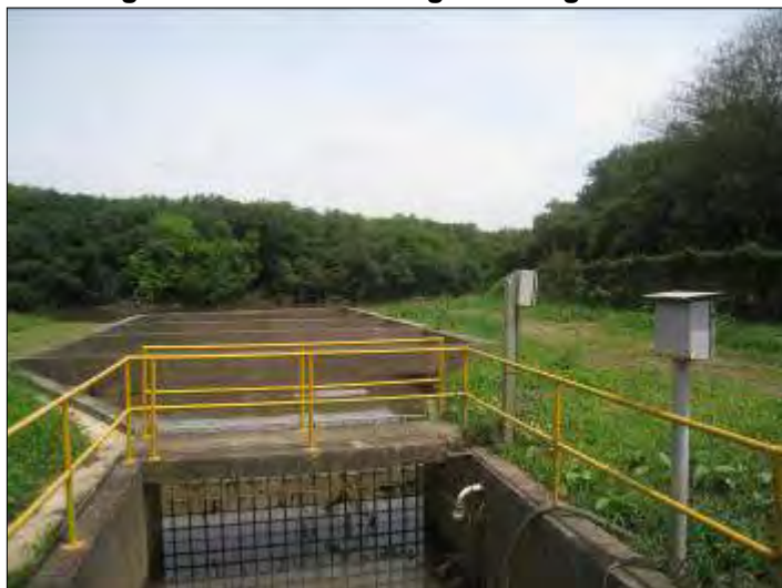
Figura 92: Canal de chegada da água bruta.
