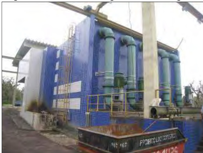
Figura 70: Reservatório de água bruta do Miringuava.
