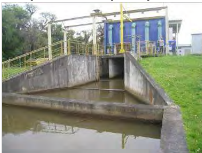
Figura 66: Canal de Chegada da Água Bruta.
