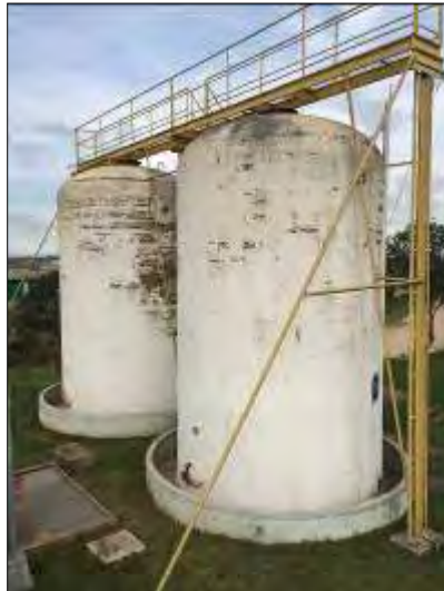
Figura 41: Tanques de armazenamento de sulfato de alumínio.
