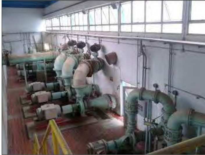
Figura 62: Conjuntos moto bomba.
