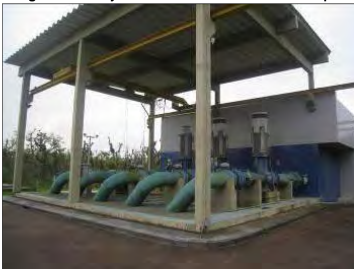
Figura 71: Conjuntos moto bomba do alto recalque.
