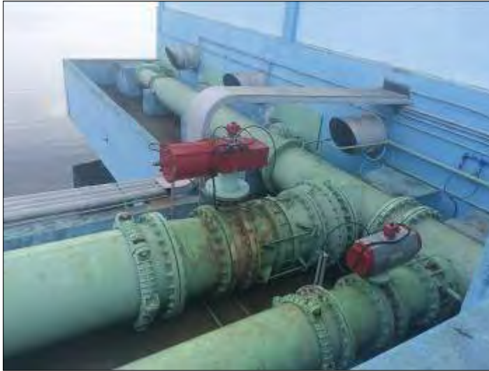
Figura 36: Válvulas Pneumáticas Automatizadas.
