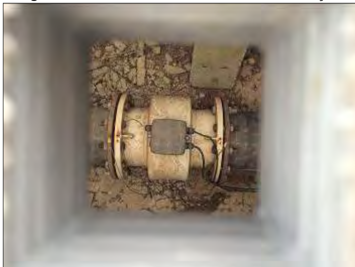
Figura 57: Macromedidor da vazão de recirculação.
