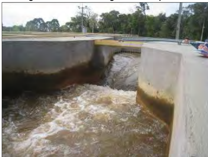
Figura 75: Caixa de chegada e calha parshall.
