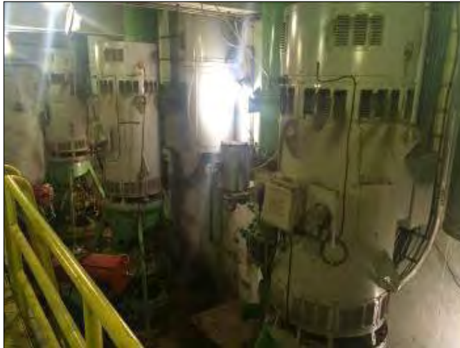
Figura 34: Estação de Recalque Profunda – Passaúna.
