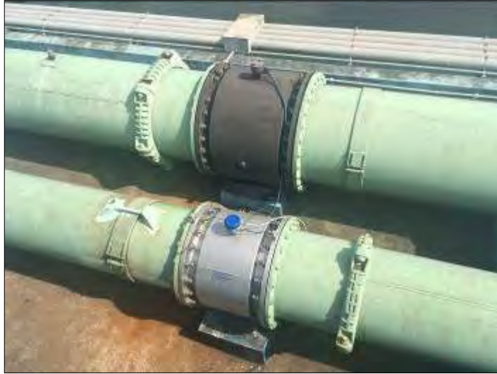
Figura 38: Medidores Eletromagnéticos de Vazão/Volume de Água Bruta do Rio Passaúna.
