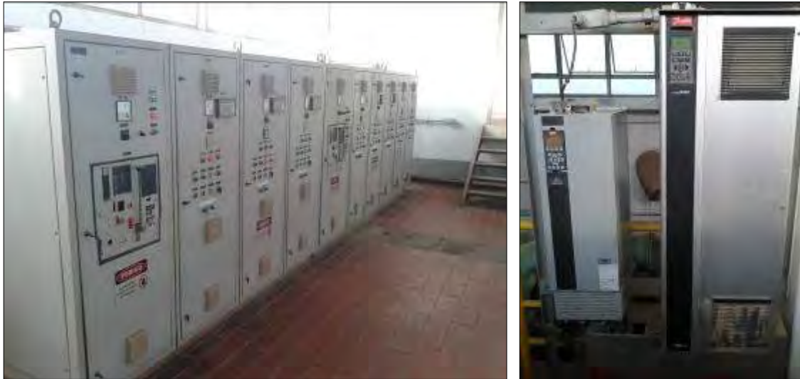
Figura 63: Painéis de acionamento dos conjuntos moto bomba.
