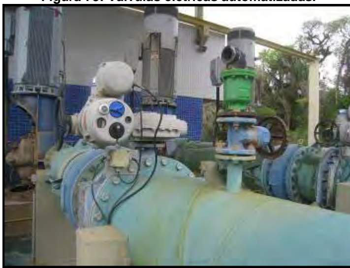
Figura 73: Válvulas elétricas automatizadas.
