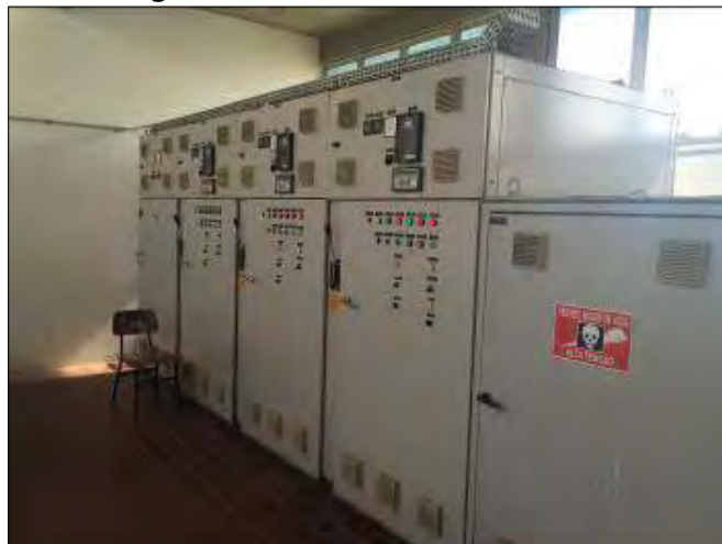
Figura 35: Painéis de Acionamento.
