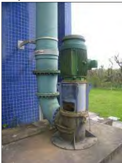
Figura 69: Conjunto moto bomba do baixo recalque.
