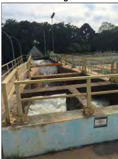
Figura 40: Caixa de Chegada e Calha Parshall.
