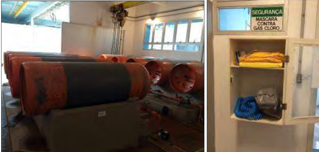
Figura 51: Abrigo do cloro gás e equipamentos de EPI.
